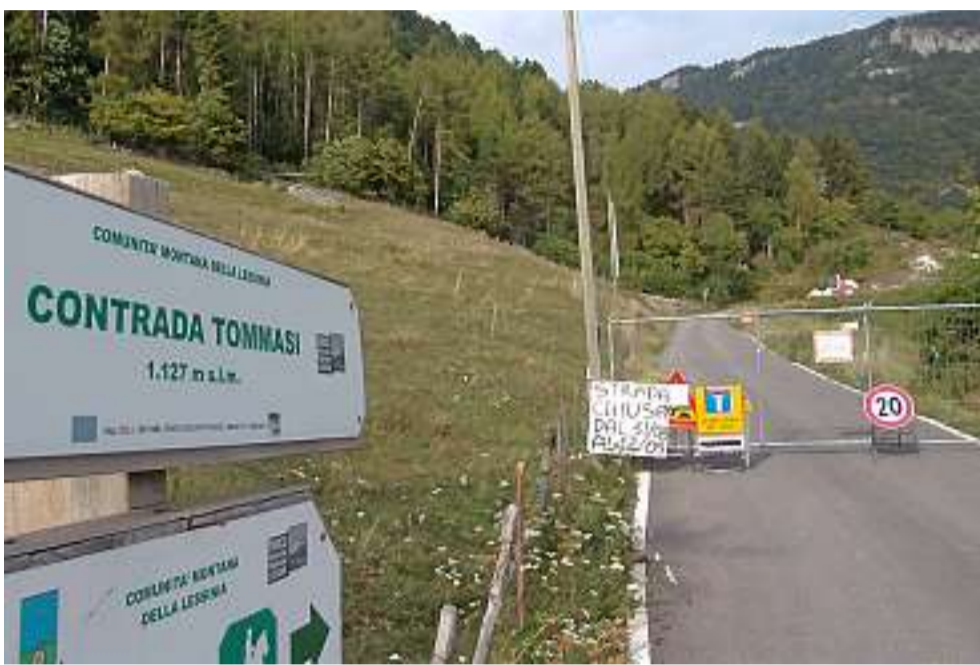
La strada Aliano, in contrada Tommasi, asfaltata con il Bio strasse che è valse la bandiera nera al Comune
